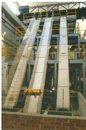
Instalación para aliviaderos escalonados
