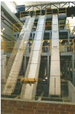
Instalación para aliviaderos escalonados
