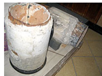
Efectos del óxido en la estructura del hormigón
